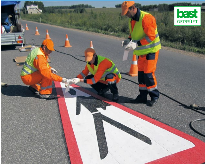
Premark-Markierungen können großflächig auf die Straße aufgetragen werden. Sie übermitteln ein deutliches Signal für Verkehrsteilnehmer.
